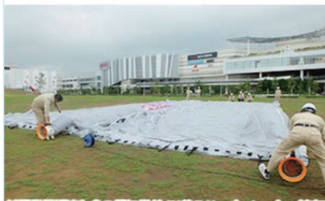
低圧発電車からの電気供給で2基のサニキュレーター(空気循環装置)が稼働した。これからパルレンシェルターに空気を送り込む。設置は約30分で可能。パルレンシェルター1基の面積は約1m四方・高さ80cm・重量約60kgであり、小型飛行機での運搬も可能。
