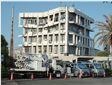
建物が大きくゆがんだ宇土市役所
